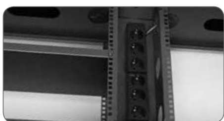
Espacio para toma de corriente
